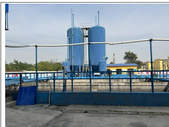
改造矿井水污水处理站
